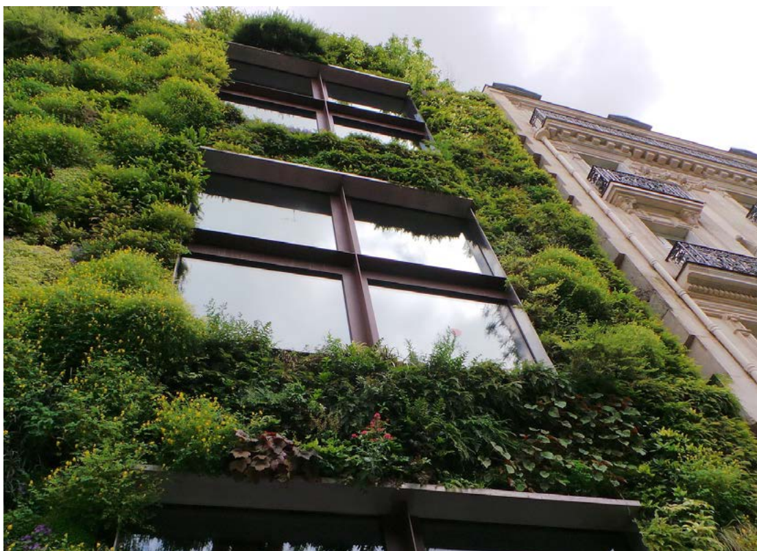
Abbildung 13: Die Begrünung von Fassaden kann sich positiv auf Wohlbefinden und Mikroklima auswirken.
